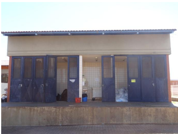
Figura 4-LIV: Armazenamento dos resíduos de serviço de saúde do Hospital Regional
