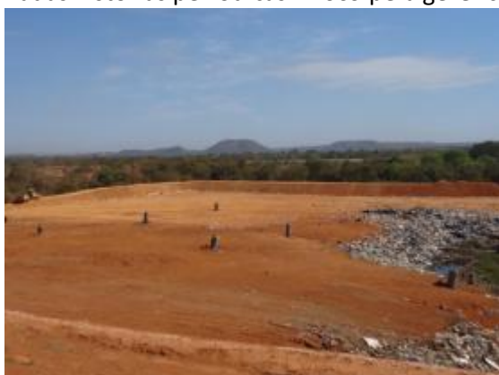
Figura 4-XXV: Área de disposição final no aterro com vistas a camada de cobertura, drenos de gases e frente de serviço
